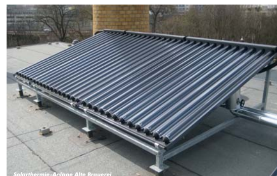
Solarthermie-Anlage Alte Brauerei
